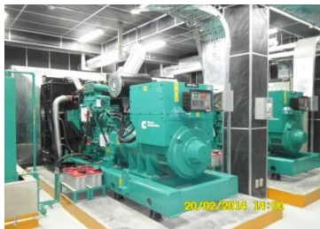
(ก) เครื่องกำเนิดไฟฟ้าชนิด เปลี่ยนติดตั้งอยู่กับที่
