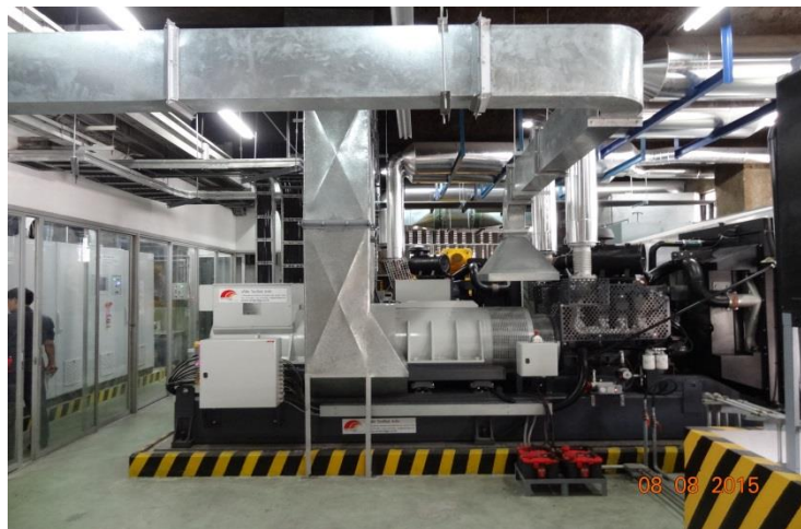
รูปตัวอย่างของระบบ Rotary UPS ที่ติดตั้งใช้งานจริงในโรงพยาบาล
