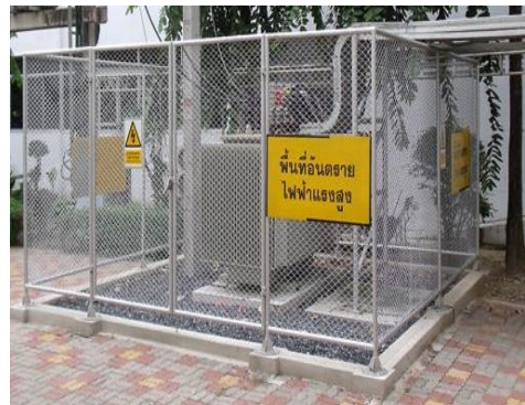
ติดตั้งบนพื้น(ลานหม้อแปลง)
