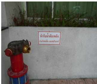
(ก) หัวรับน้ำดับเพลิงที่ไม่มีฝาครอบ
