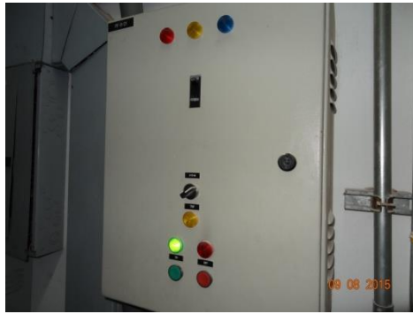
ตู้ควบคุมระบบ
