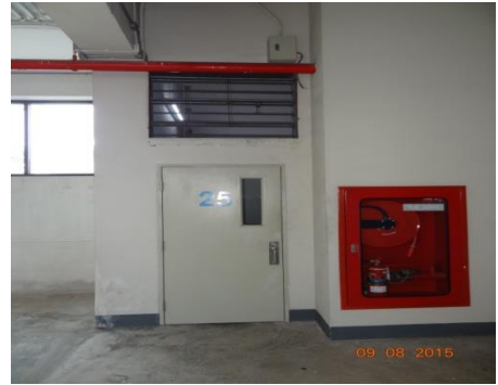
ช่องระบายแรงดันเกิน
