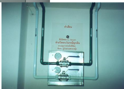
ZONE VALVE ประจำชั้น/ห้อง ต้องมีป้ายชี้บ่ง
